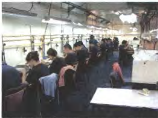
Fig. 16. Área de soldadura. Instalaciones de tubería de gas y oxígeno para little torch.
