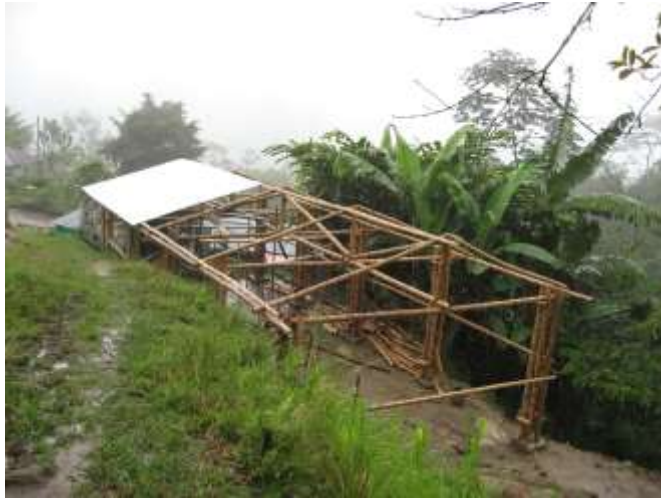
Foto12: vista parcial estructura e inicio de techado sitio de descortezado y almacenamiento, planta piloto de descortezado
