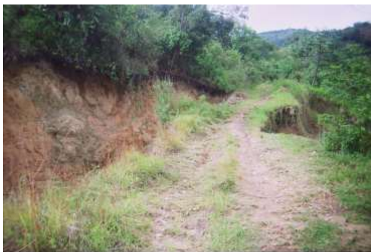
Foto: deslizamientos y destrucción de la vía de acceso al sitio donde se adelantaron las obras para la planta de descortezado de mimbre
