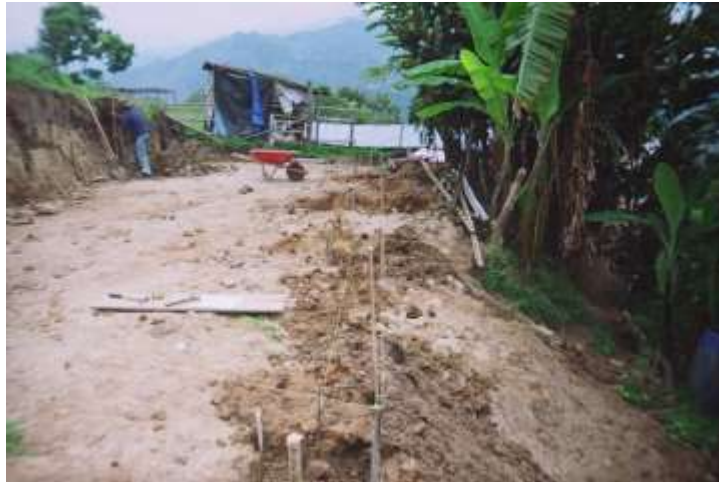
Foto 7: trabajos de alinderado y excavado para zapatas. Planta de descortezado de mimbres
