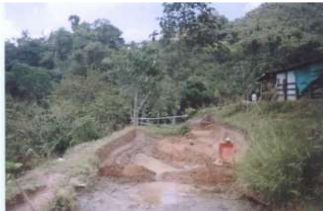
Foto 1: excavación y remoción de tierra en el área para la construcción del estanque
