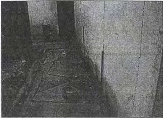
Estado de deterioro
