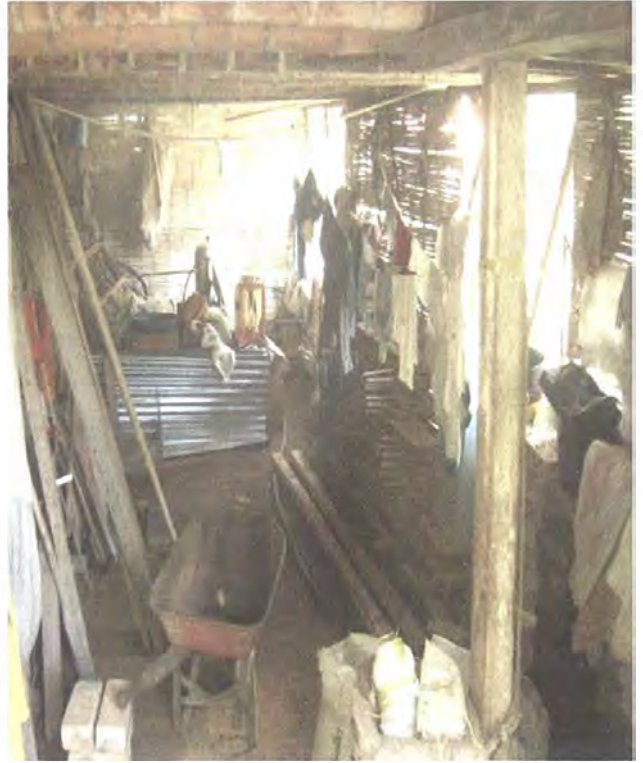
Foto 81 Lugar donde se ubicaran los equipos.
