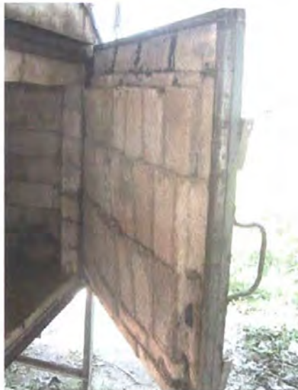
Foto 120 Pared Interna desprendida de la puerta
