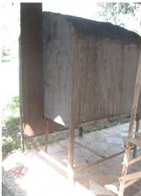
Foto 126 Sistema de desfogue calor chimenea
