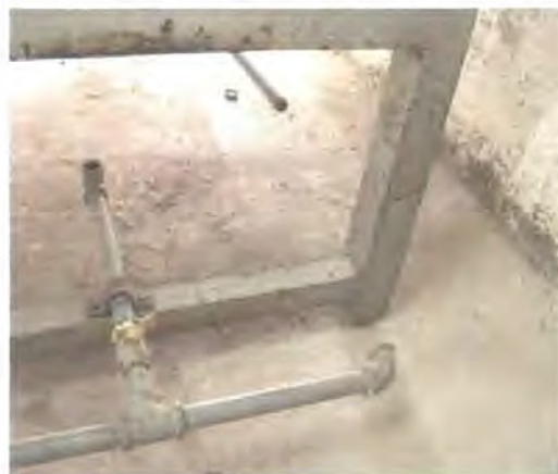
Foto 40 Ausencia de codos de conexión
