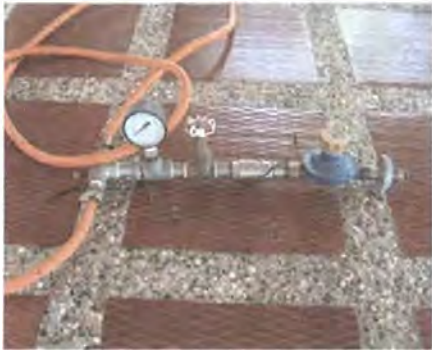
Foto 127 Registros de ingreso del gas
