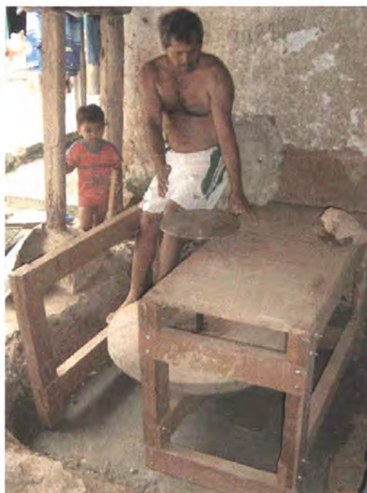
Foto 32 Torno instalado y terminado
