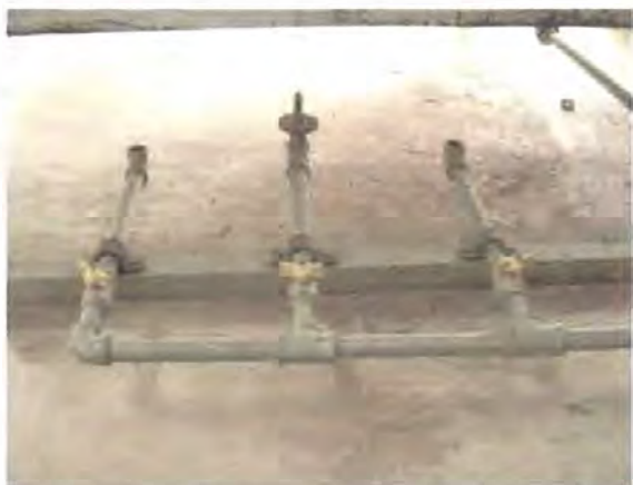
Foto 39 Ausencia de quemadores atmosféricos
