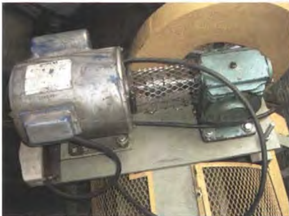
Foto 49 Motor y motor reductor estado actual
