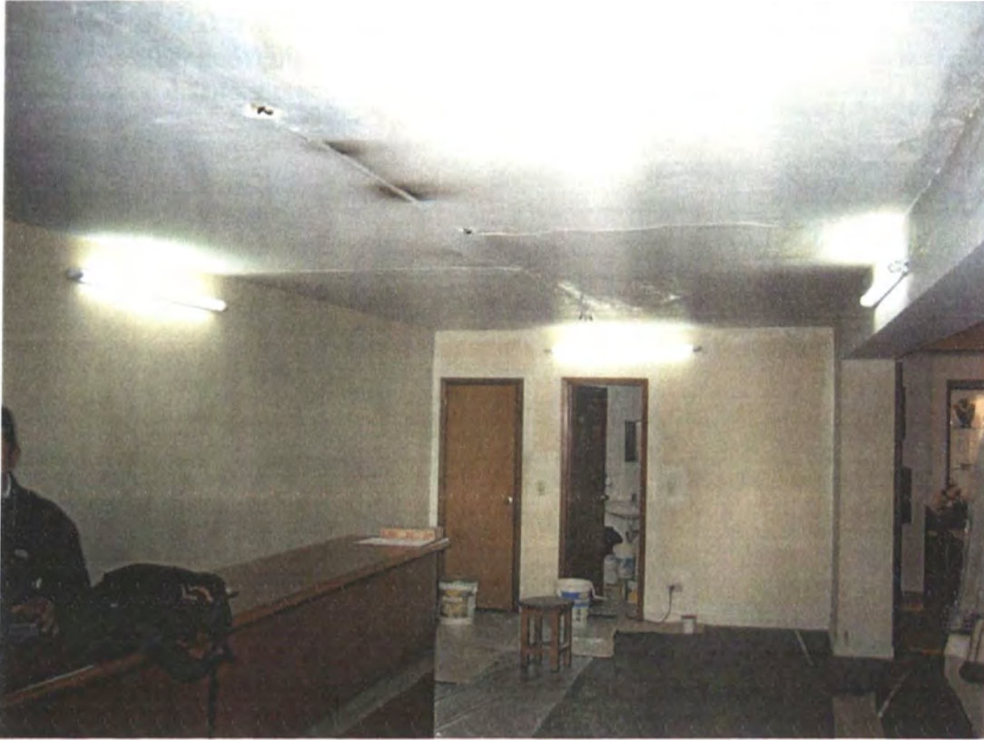
Instalaciones eléctricas inadecuadas y marcas de quemaduras en el techo. Estado anterior. Foto: Camilo Aldana. Laboratorio Colombiano de diseño 2006
