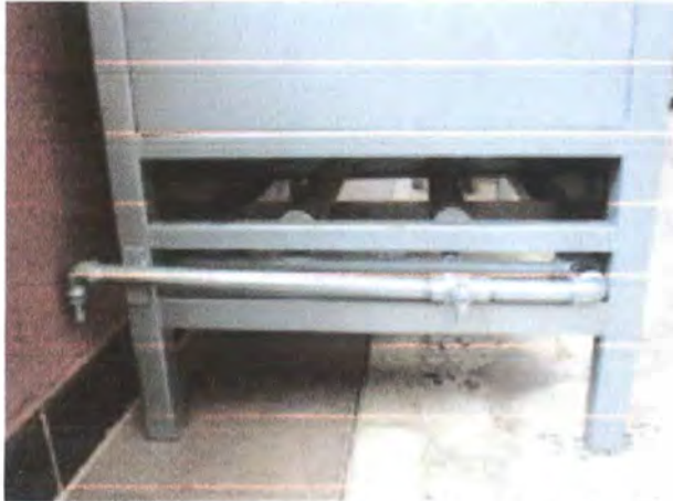
Sistema de encendido del gas. Foto Luz Dary Rosero Feb 2007
