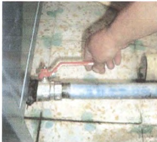
Extensión de sistema de desagüe.
