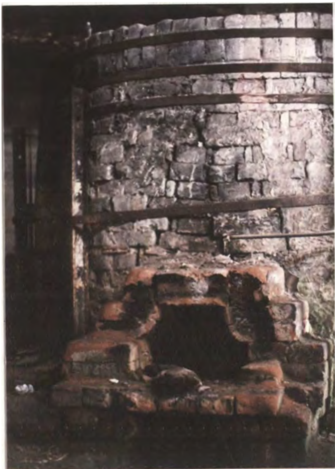
137. Horno en enfriamiento luego de cocción.
